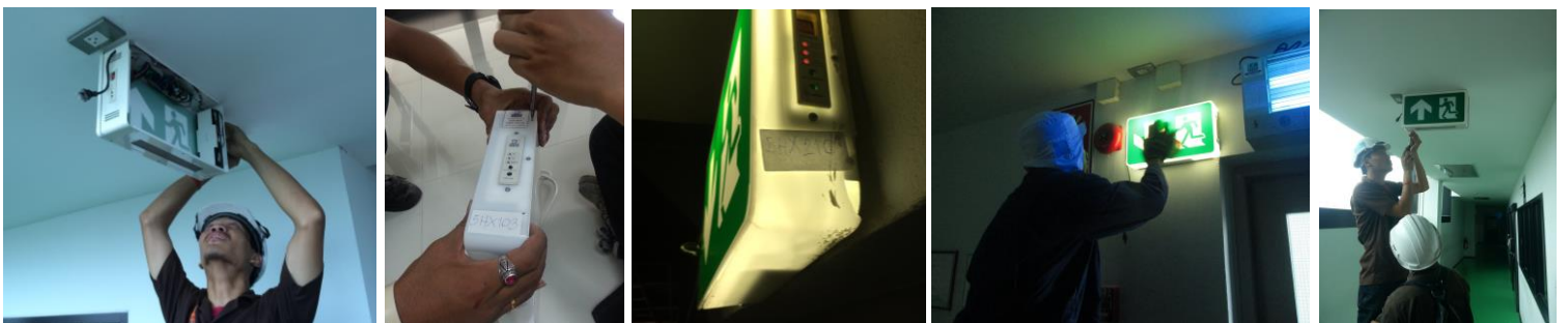
ตรวจสอบความเสียหาย
